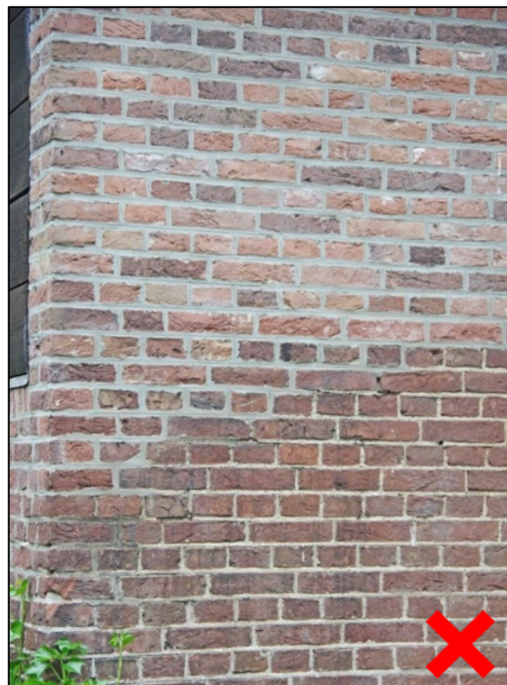
Hersteld metselwerk. Onderin oorspronkelijk met iets besneden voeg. Er boven verkeerde kleur baksteen met een te grijze en te brede voeg.
