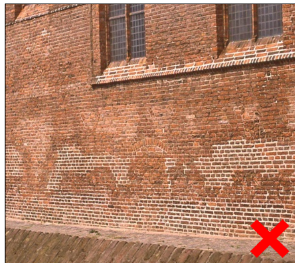
Metselwerk van een kerk in de binnenstad; al diverse malen geteisterd door graffiti. Door herstel ontstaat toch een te vlekkerig geheel. Ontstoren was op z'n plaats geweest.
