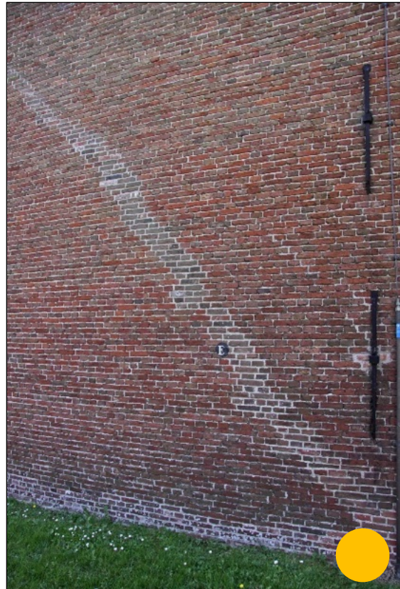
Een ingeboete scheur met herstel voegwerk in de gevel van een kerk. Net iets te opvallend, blijft lang zichtbaar. Licht ontstoren was beter geweest.
