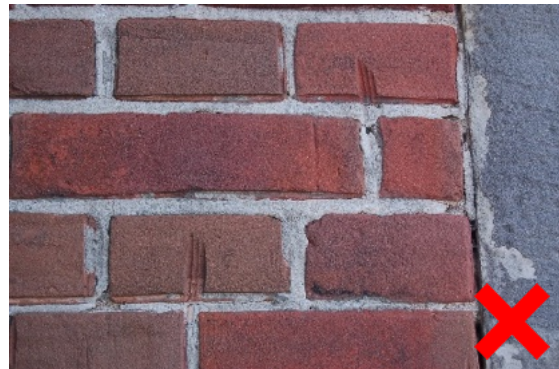
Beschadigde baksteen door een slijpschijf. Komt regelmatig voor. De baksteen is onherstelbaar beschadigd.
