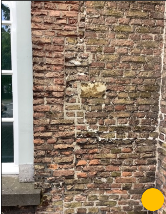
Wat rommelig metselwerk door diverse bouwsporen. Dit biedt qua herstel wat meer ruimte voor de kleur van herstel van het voegwerk.
