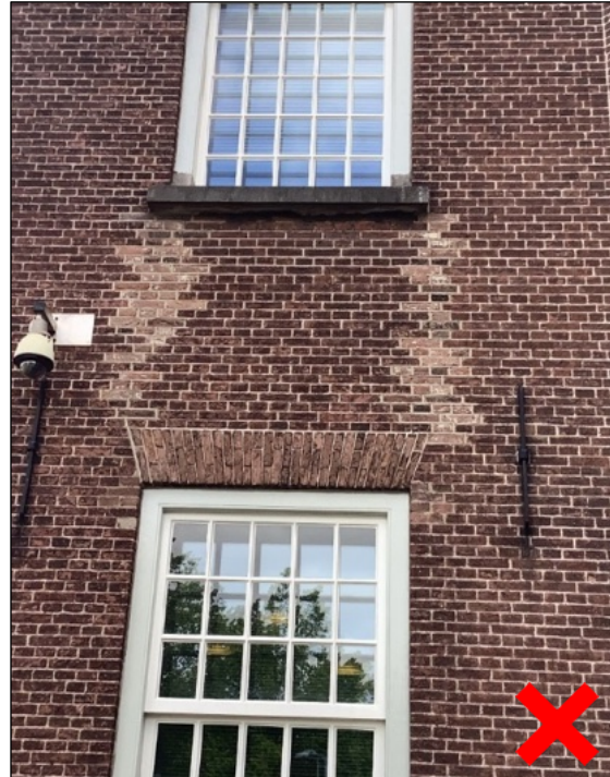
Een storend herstel dat heel lang zichtbaar blijft in een vrij egaal metselwerk. Ontstoren door donker te kleuren en het ergste zwart van het metselwerk af te halen.
