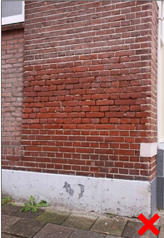
Verdwenen voegwerk in zone op 1,5 meter hoogte boven maaiveld. Voor herstel oorzaak nagaan! Optrekkend vocht dampst uit, zie lekke spatplint.
