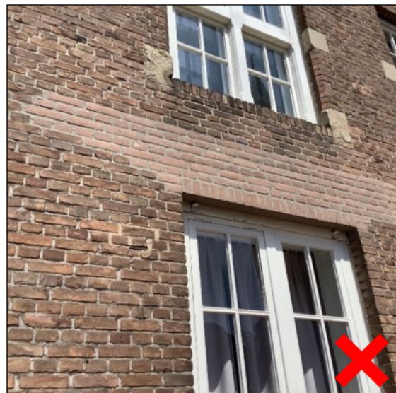
Vernieuwd metselwerk boven het kozijn. Qua kleur wijkt dit metselwerk zodanig af, dat bijkleuren het oorspronkelijke beeld had hersteld.
