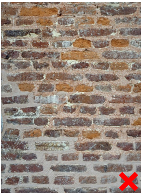
Oorspronkelijk voegwerk met baksteengrit. Eerst zorgvuldig de voegmortel analyseren en proefstukjes zetten. Het nieuwe voegwerk voldoet niet aan deze eis.
