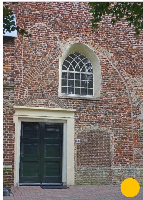
Herstel voegwerk bij bouwsporen biedt iets meer ruimte. Bijkleuren bij dichtgezette rechter toegang had een overweging kunnen zijn.
