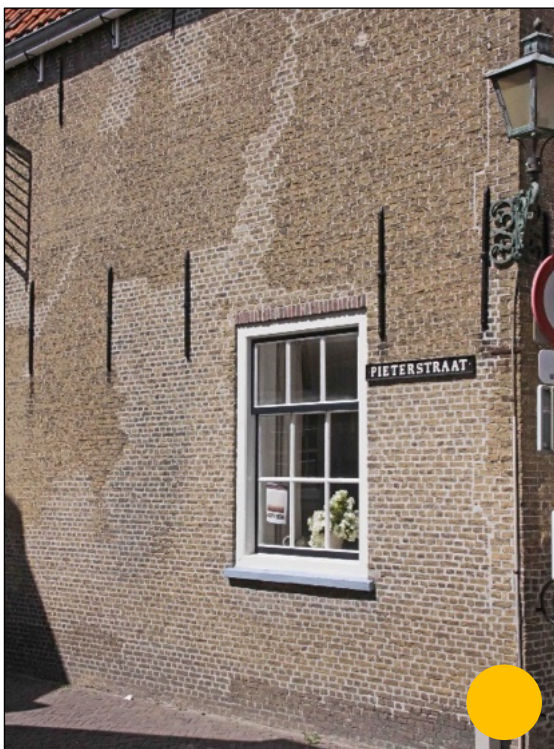
Een woonhuis op een hoek, met enkele zettingsscheuren, gevoegd in samenhang met voegwerk om het venster. Als opdrachtgever dit goed vindt, acceptabel.
