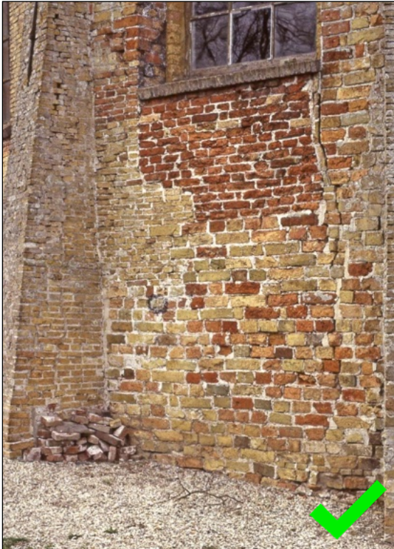
Een koorsluiting van een klein zaalkerkje in Friesland, voor herstel. Heel veel bouwsporen en formaten baksteen.
