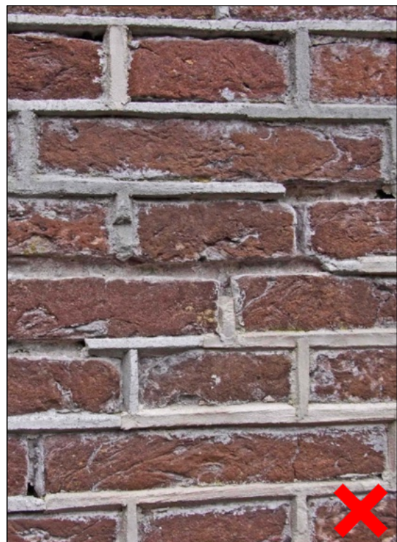
Voegen te ondiep uitgehaald. De (te grijze) snijvoeg heeft te weinig massa, ligt er als het ware op. Al circa 5 jaar na het aanbrengen knapten de voegen er al uit!
