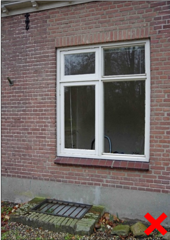
Vals metselwerk met een te bleke baksteen rond een kozijn uit de jaren '60 van de 20e eeuw.
