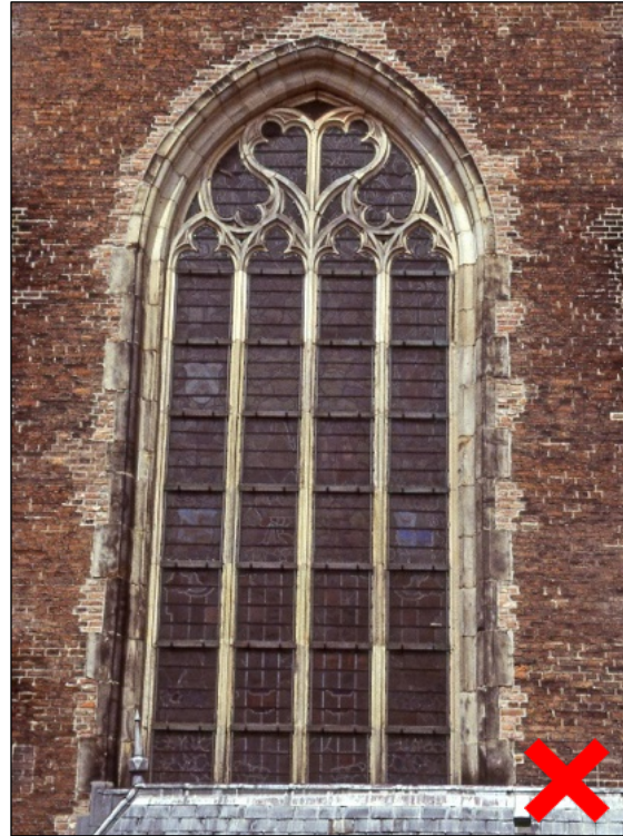
Hetzelfde venster circa 25 jaar later. Het herstel blijft hinderlijk zichtbaar. Door vanuit het herstellde metselwerk een brede rand voorzichtig te reinigen, was het niet zo zichtbaar gebleven.
