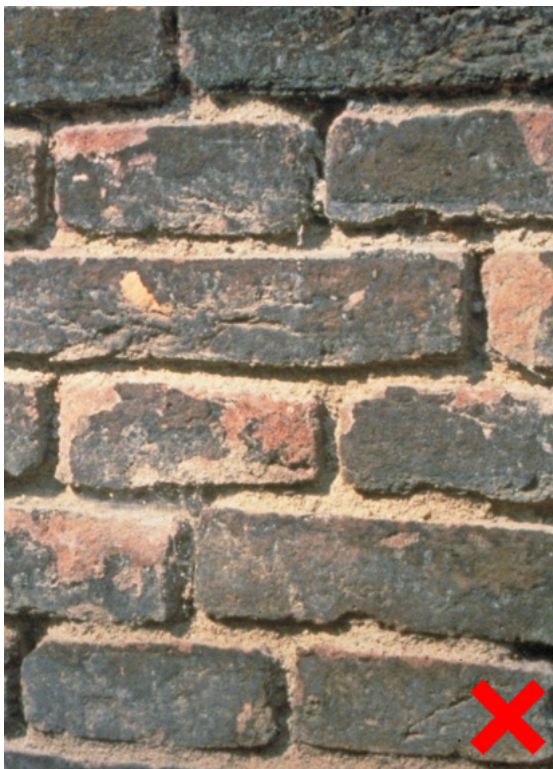
Dat krijg je als je een kwetsbare handvormsteen uit de 18e eeuw te lijf gaat met een te brede beitel. Overal zijn door randspanning scherven van de baksteen afgesprongen.
