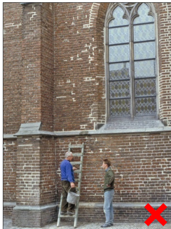
Keuring volgens het instandhoudingsplan is incidenteel voegwerk herstel. Veel te vlekkelig. Hier had zeker ontstoren een kans moeten krijgen.
