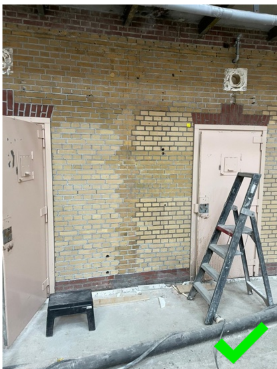
Herstel van metselwerk in een herbestemde koepelgevangenis. Het nieuwe metselwerk steekt te sterk af.
