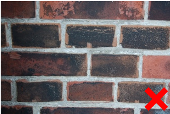
Vorstschade van het voegwerk, ontstaan omdat de kalkmortel nog niet voldoende afgebonden was. Voegen met kalkmortel alleen boven 10°C en minimaal 3 x 24 uur vorstvrij.
