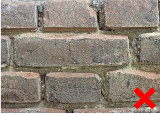
Oorspronkelijk een smalle besneden voeg. Met grof geweld uitgeslepen met een veel te brede slijptol. Onherstelbaar beschadigd.
