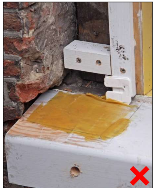
Een detail van hetzelfde kozijn. De nieuwe kozijnstijl sluit op geen enkele manier aan op de oorspronkelijke constructie.
