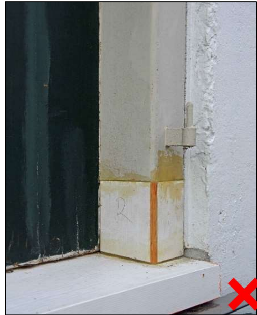
Van hetzelfde pand de 'herstelde' onderdorpel. Recht afzagen, plakken op de onderdorpel zonder verbinding en klaar is Kees? Dit voldoet op geen enkele manier aan de zorgvuldigheid, die de URL 4001 'Historisch timmerwerk' eist.
